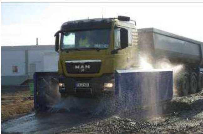
Reifenwaschanlage für LKW während des Ausbaus der stark belasteten Bodenbereiche – Januar – Dezember 2009
